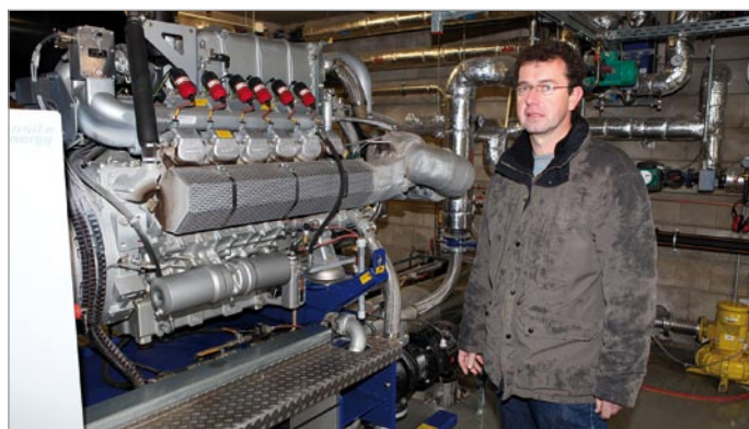
Die 400 kW-Bio-gasanlage ist der jüngste Einkommenszweig im Unternehmensverbund. Sie vergärt vor allem Gülle, Mais und Gras und fügt sich so perfekt in den Produktionskreislauf ein.
