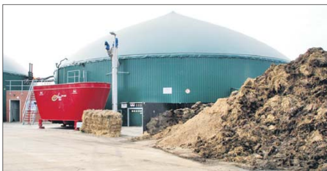
Die Biogasanlage wird vor allem mit Gülle und Stallmist betrieben. Dort können 400 kW Strom erzeugt werden.
